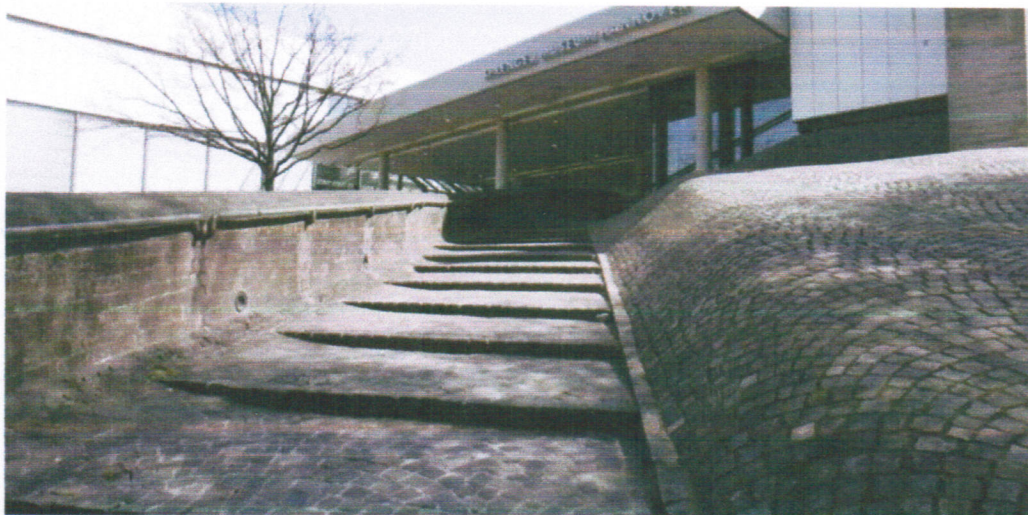
Die Kosten für Brandschutzsanierung kletterten im Sprengel Museum von vier auf elf Millionen Euro. Quelle: Christian Behrens
